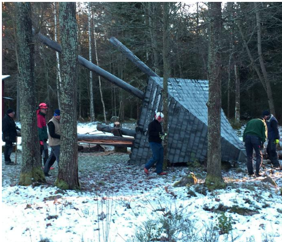
Klockstapeln är fälld efter att benen börjat ruttna. Foto: lok.se
